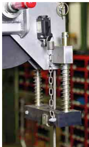
Ein Funk-Seilzugschalter veranlasst den Stopp der Winde, wenn die Kranflasche die Endposition erreicht.
